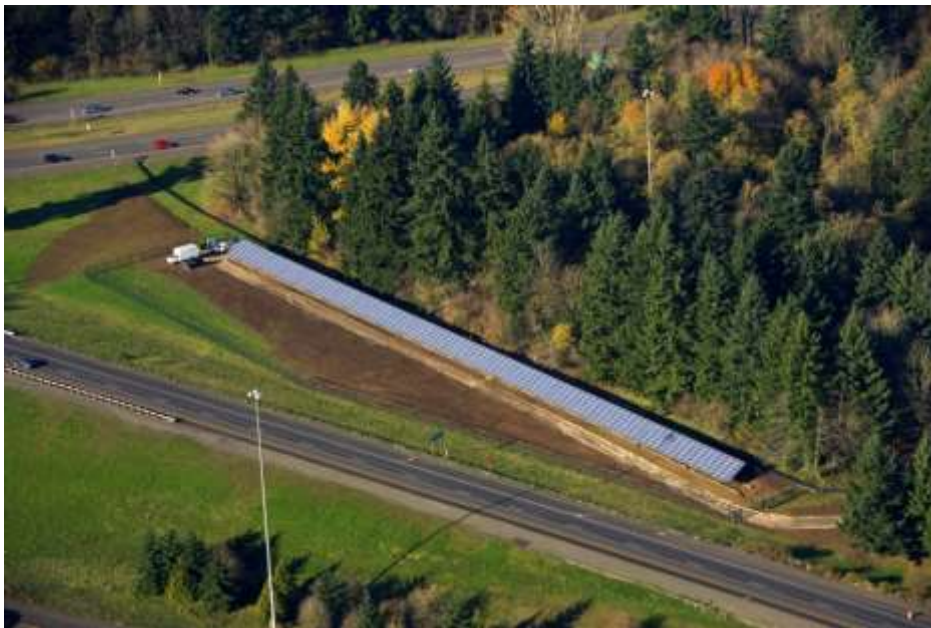
Орегон, США Солнечные батареи на крыше
